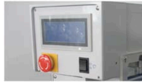
SPS-Steuerung mit Touch Screen Bedienfeld
